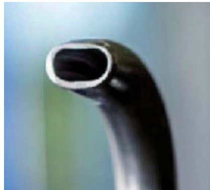
Bild 2: Eine häufig in der Industrie zu findende, aber meist ineffiziente Druckluftanwendung sind offene Rohre.
