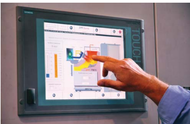
Bild 2: Neben den energetischen Aspekten wurde bei dem neuen Schmelzofen auch die Handhabung der Steuerung dank eines Touchscreens einfacher und bequemer gestaltet.
