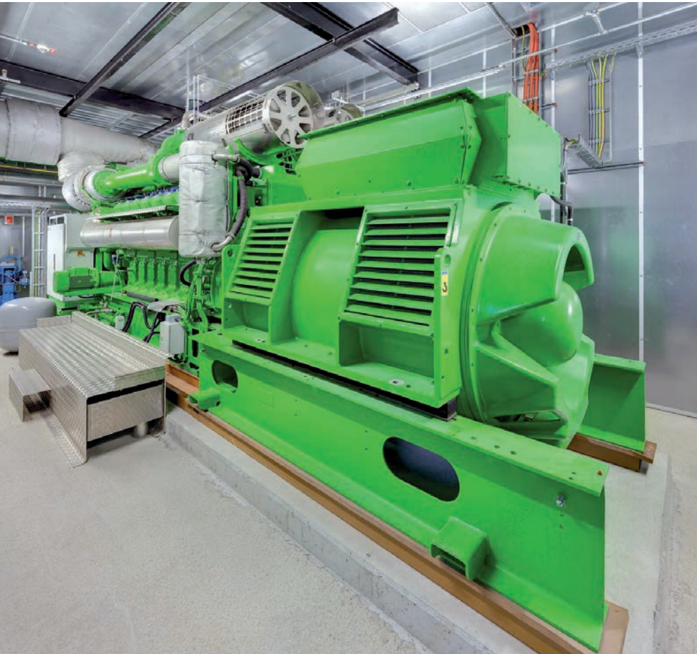
Bild 3: Ein zusätzliches Blockheizkraftwerk mit einer Leistung von 2,4 MW th und 2,6 MW el komplettiert das neue Energiekonzept, sodass durch die neuen Anlagen die Grundlast praktisch vollständig abgedeckt werden kann.
