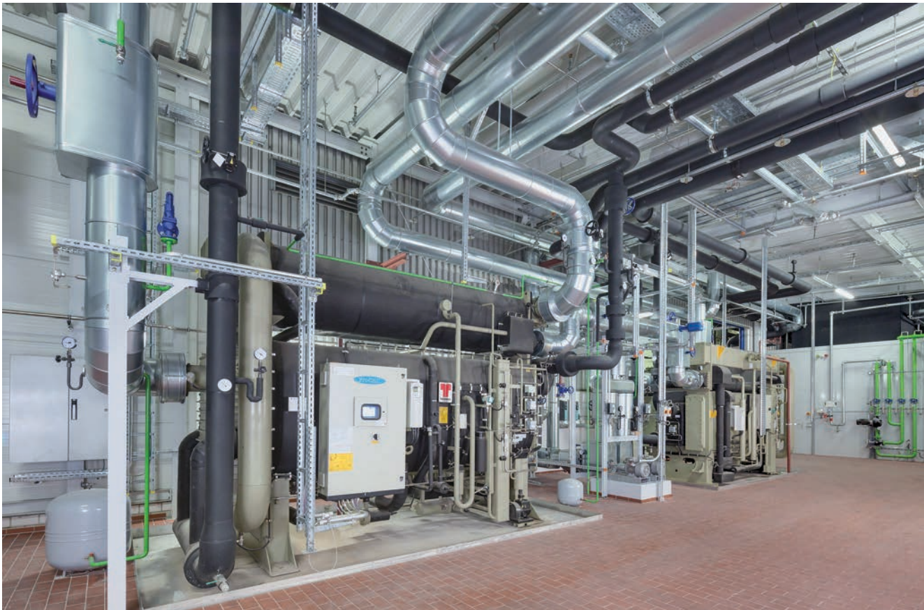
Bild 2: In der Energiezentrale des BMW Group-Werks Landshut wurden zwei Absorptionskältemaschinen errichtet, die sich aus dem zentralen Wassernetz speisen und die Abwärme aus den Schmelzöfen nutzen, um Kälte zu erzeugen.
