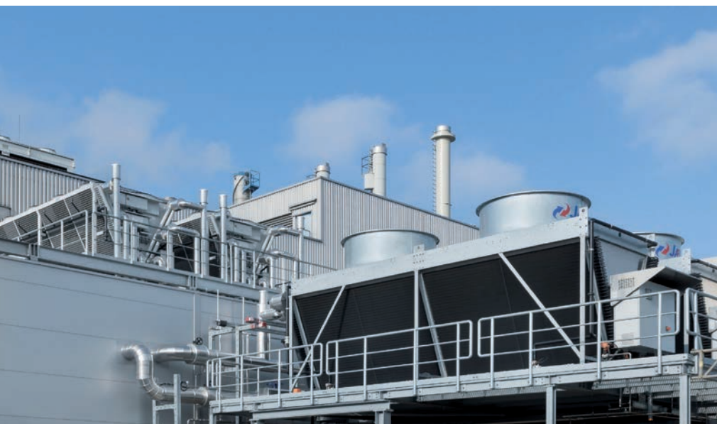
Bild 4: Moderne hybride Trockenkühler ergänzen das Energiekonzept im BMW Werk Landshut.
