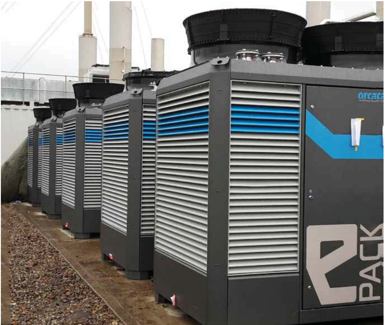
Bild 3: Oft können noch mehrere Megawatt an thermischer Energie genutzt werden, wenn ePacks als Stack installiert werden.
