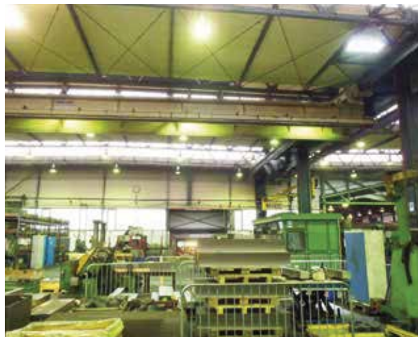
Bild 1: Halle mit HQL-Beleuchtung und Testinstallation in der ersten Reihe (links alternatives LED-Modell, Mitte HQL, rechts später montierte Philips LED-Leuchte).
