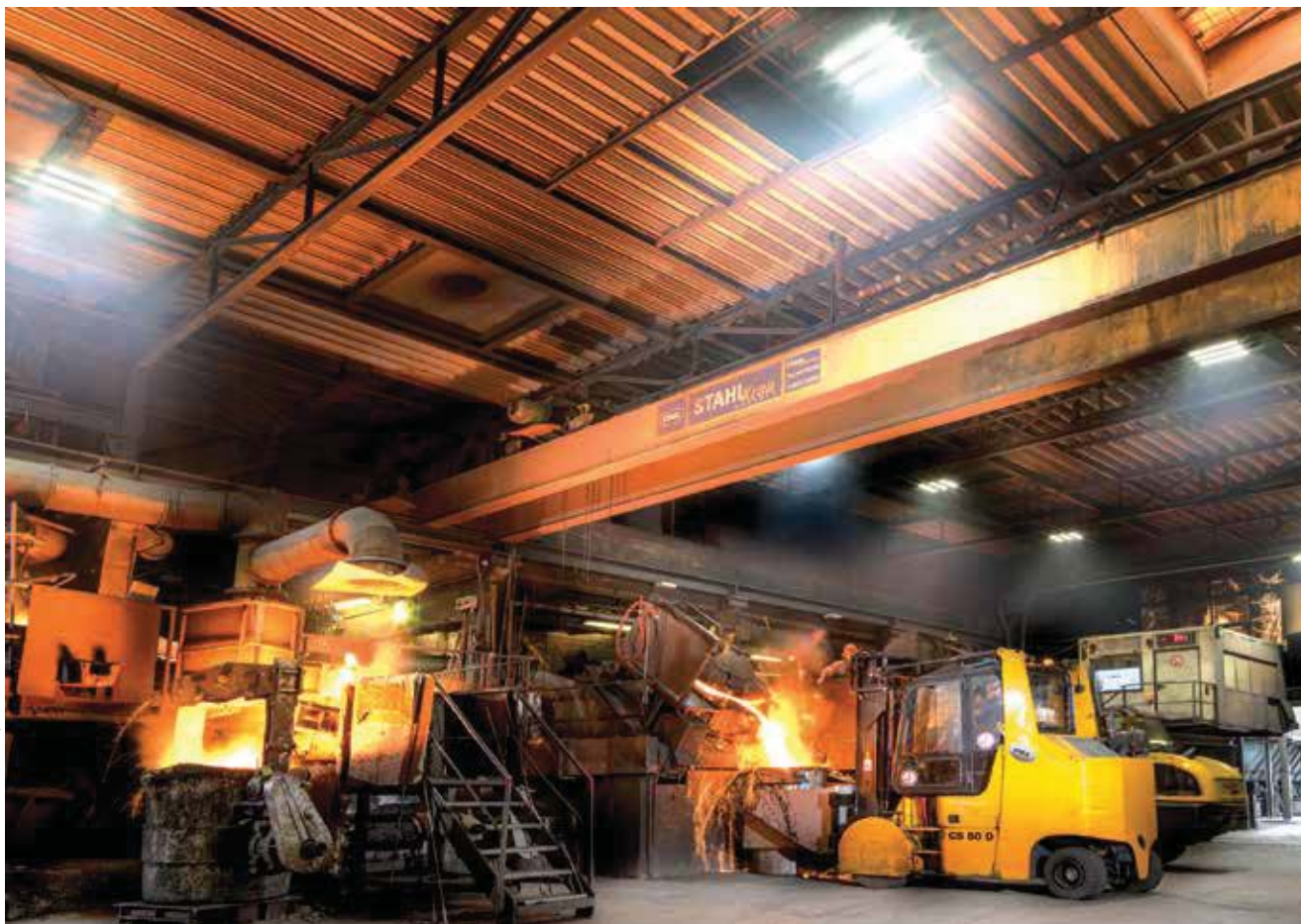
Bestens ausgeleuchtet dank moderner LED-Hallenstrahler.
